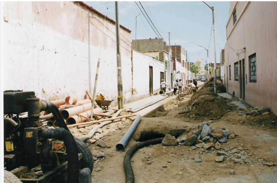
Fig. 36 Reparación de los desagües en la ciudad de San Pedro de Lloc, sin mantenimiento por varias décadas, y erosionados por la napa freática
