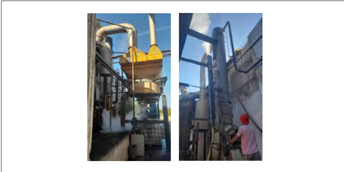
IMAGEN 4. Mediciones a la salida del conducto del lavador de gases
