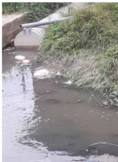
Figura 27. Punto 6. Calle Buenos Aires. Tubería que sale al canal procedente del Colegio Naval, pegada a la tubería del Hospital EsSalud
