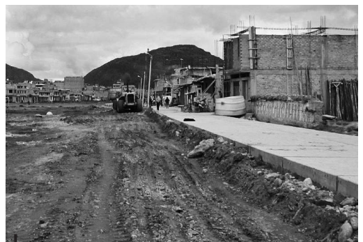
Figura 11 – Limpieza de los materiales de construcción acumulados por vecinos en el área recreativa, a cargo de la municipalidad
