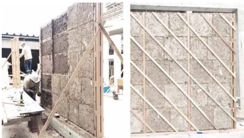
Figura 3. Vistas del panel experimental con estructura de madera y elementos prefabricados de tierra alivianada.
