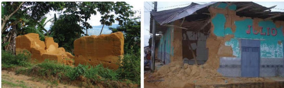
Figura 7. Izquierda: Deterioro por lluvias. Fotografía: Teresa Montoya, 2015. Derecha: Fallas por terremoto. Fotografía: Diario La República, 2005.
