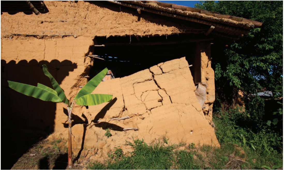
Figura 3: Desplome de una esquina de la antigua municipalidad, 2013. Foto: Augusto Román.
