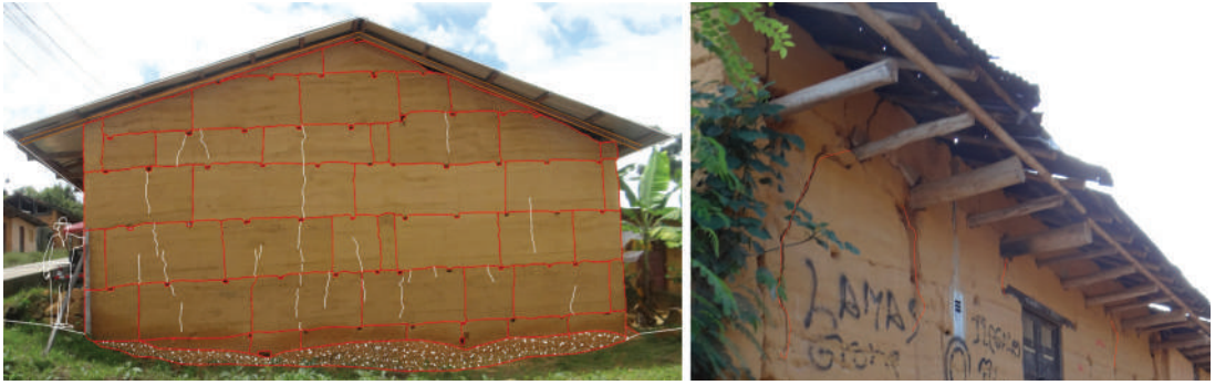
Figura 9. Izquierda: Separación entre bloques de tapial y grietas de secado. Derecha: Grietas por carga puntual de vigas madre. Fotografías: Julio Vargas y Teresa Montoya, 2015.
