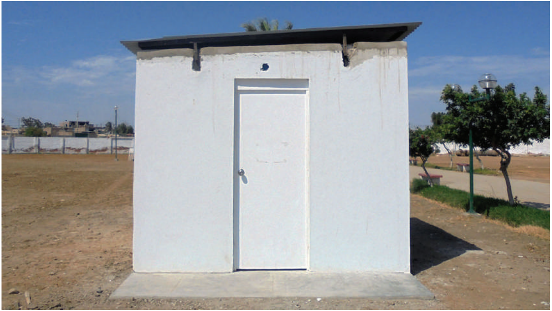
Figura 10. Vista del módulo de bloquetas de concreto con el sobretecho de plancha metálica ondulada.
