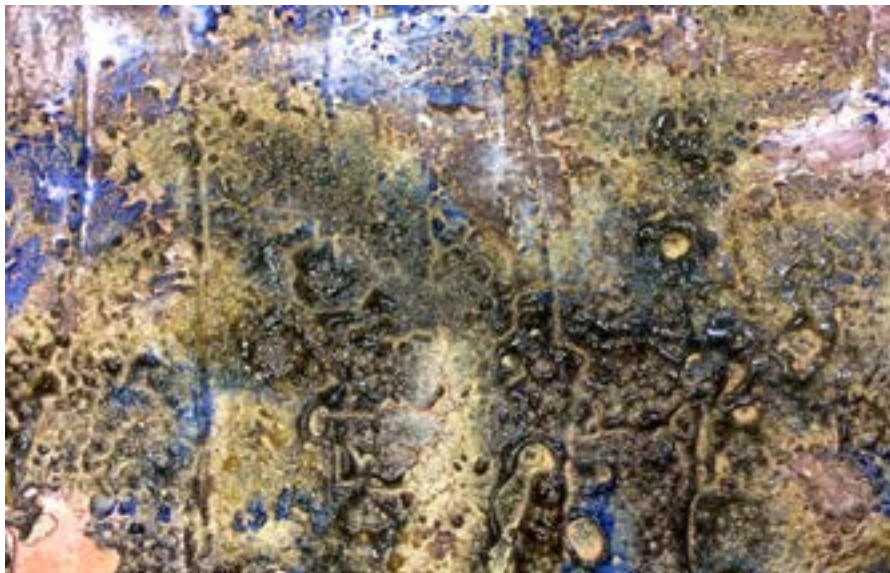
Figura 9. Óxidos metálicos activados, cristalizados, pero muy inestables adheridos con fragilidad a cemento refractario.
