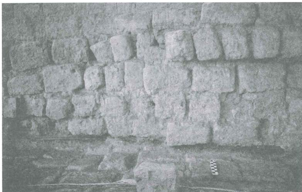
Fig. 3.11. Evidencias de caña brava utilizada como amarre estructural en el interior del muro colapsado de la plataforma superior.
