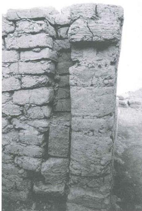
Fig. 3.17. Adobes colocados de canto y restos de dintel de caña brava al sur del recinto 5, Edificio D.
