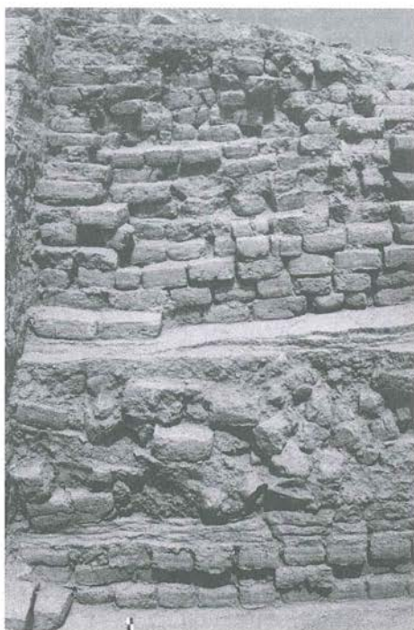
Fig. 3.26. Perfil que muestra las sucesivas reparaciones de los pisos. Corredor que une el frontis principal con la plataforma superior.
