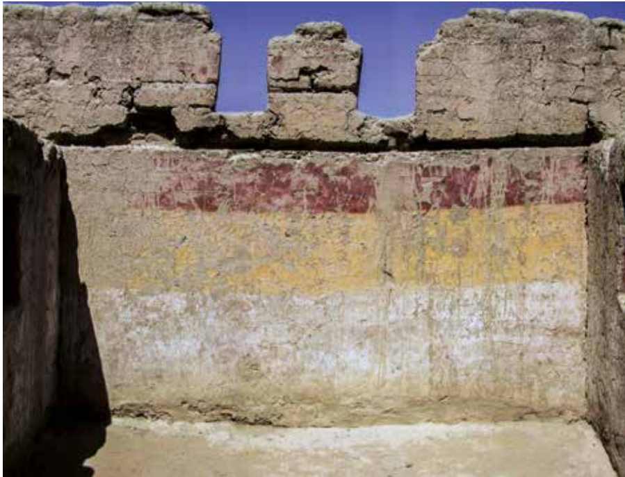
Figura 32. Las paredes se encuentran pintadas con bandas horizontales de color blanco, amarillo y rojo
