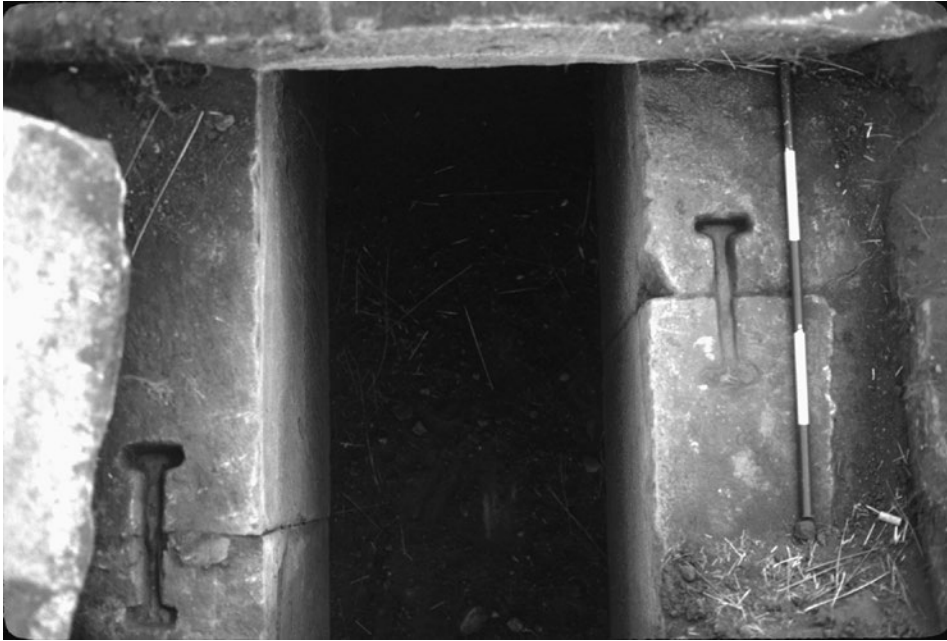
Figura 2.64. Grapas in situ en el canal en el lado sur de Pumapunku.
