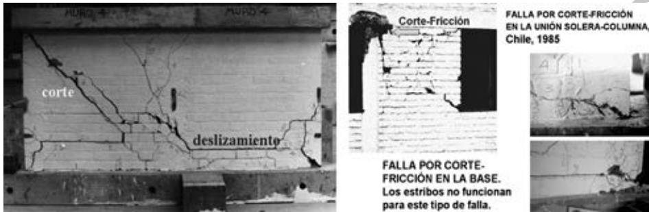
Fig. 7.8. Cizalle en muros confinados.
