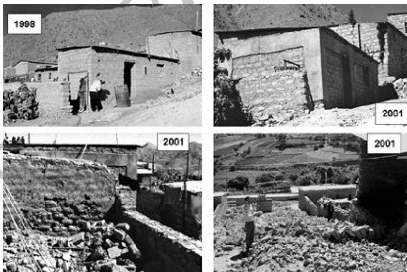
Fig. 8.46. Yacango, Moquegua. Terremoto del Sur del 23 de junio del 2001.
