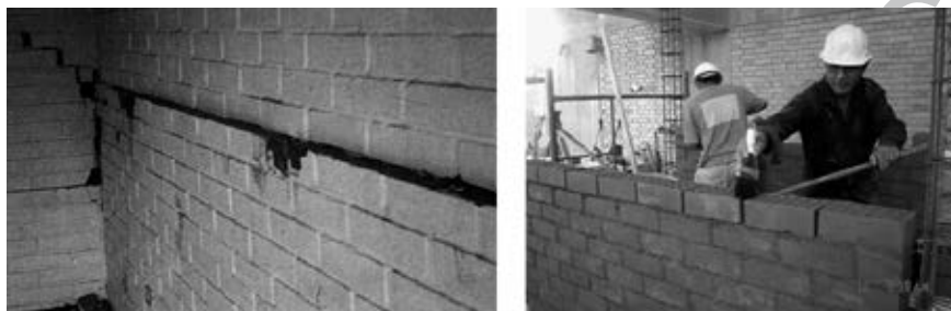
Fig. 4.33. Falla por cizalle y humedecimiento de la junta de construcción.
