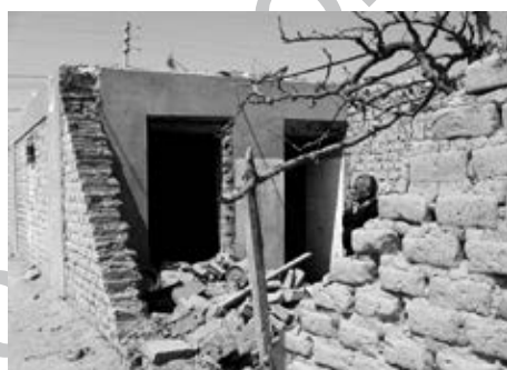
Fig. 8.51. Cerco no reforzado. 2007.
