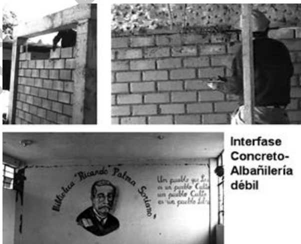
Fig. 5.23. Fisuras en el contorno del tabique.
