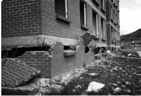
Fig. 7.10. Falla del primer piso.
