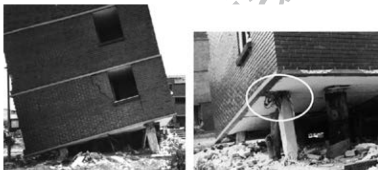
Fig. 5.29. Colapso de un edificio con piso blando.
