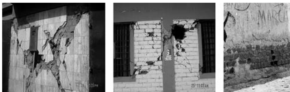
Fig. 4.18. Trituración de ladrillos King Kong artesanales en el sismo de Pisco del 15-08-2007 y deterioro por acción de la intemperie en zona no tarrajada.
