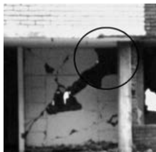
Fig. 5.33. Falla por aplastamiento.
