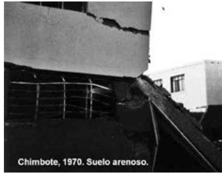
Fig. 5.2. Colapso de una vivienda.
