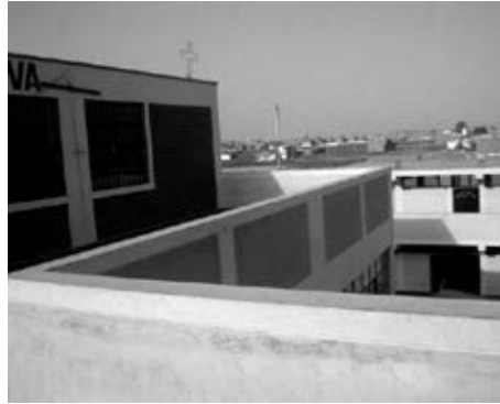
Fig. 7.90. Parapeto arriostrado que soportó el sismo de Pisco, 2007.
