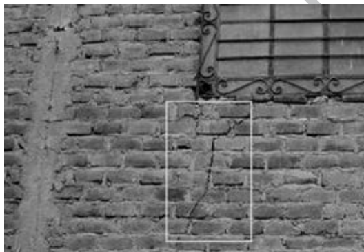
Fig. 6.22. Grieta en el alféizar.
