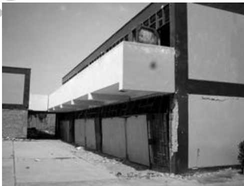
Fig. 6.17. Pisco, con daños.
