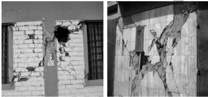
Fig. 2.52. Edificaciones de 3 pisos hechas con ladrillos artesanales de arcilla. Sismo de Pisco, 2007.
