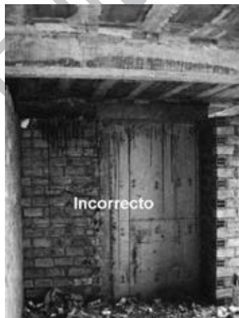
Fig. 6.34. La placa no debe conectarse con la albañilería en el mismo plano.
