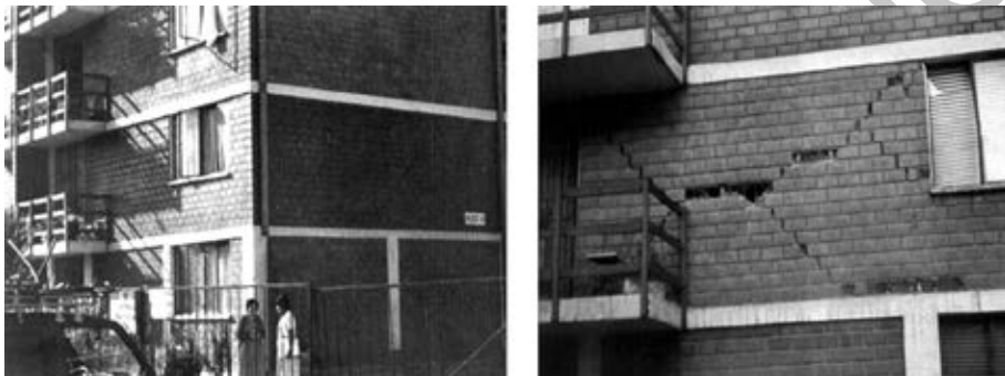
Fig. 4.98 (Ref.8). Edificio chileno de 4 pisos antes del sismo de 1985 (izquierda) y después del sismo (derecha). El primer piso es de albañilería confinada y los 3 pisos superiores son de albañilería armada parcialmente rellena. La falla por corte se produjo en el segundo piso. Nótese en la foto de la derecha el grout en las celdas donde existe refuerzo vertical y la trituración de los ladrillos vacíos.
