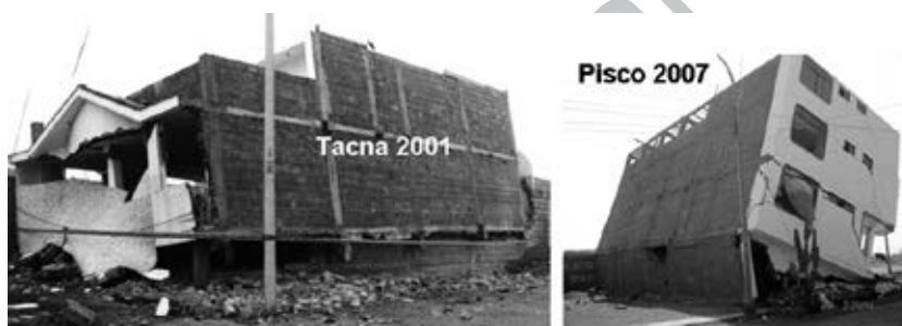
Fig. 6.15. Colapso por escasa densidad de muros.
