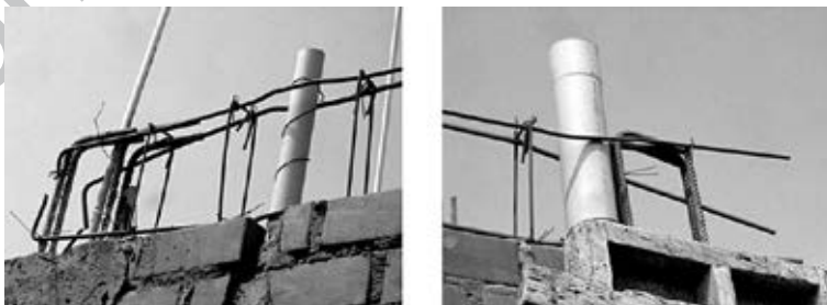
Fig. 4.48. Varillas dobladas, solución incorrecta.
