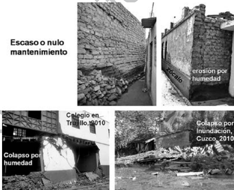
Fig. 8.29. Efectos de la humedad e inundaciones.
