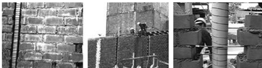
Fig. 4.37. Muro dividido en 2 por la tubería y uso de falsas columnas.
