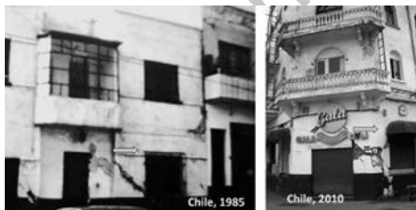
Fig. 7.25. Falla por corte en el primer piso de una vivienda no reforzada.
