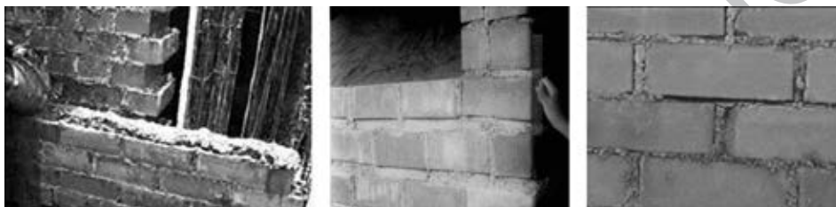
Fig. 4.26. Errores en: extensión del mortero, grosor de juntas y fluidez.
