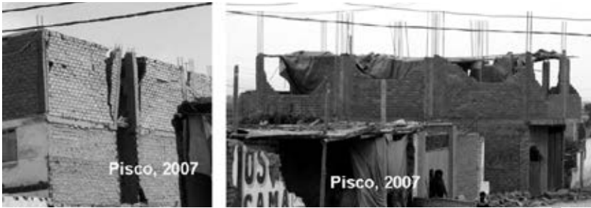
Fig. 6.8. Ausencia de diafragma rígido y de soleras.
