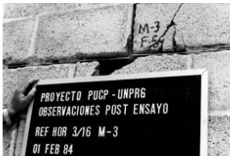
Fig. 2.66. Rotura de una barra horizontal trefilada y deterioro del muro.
