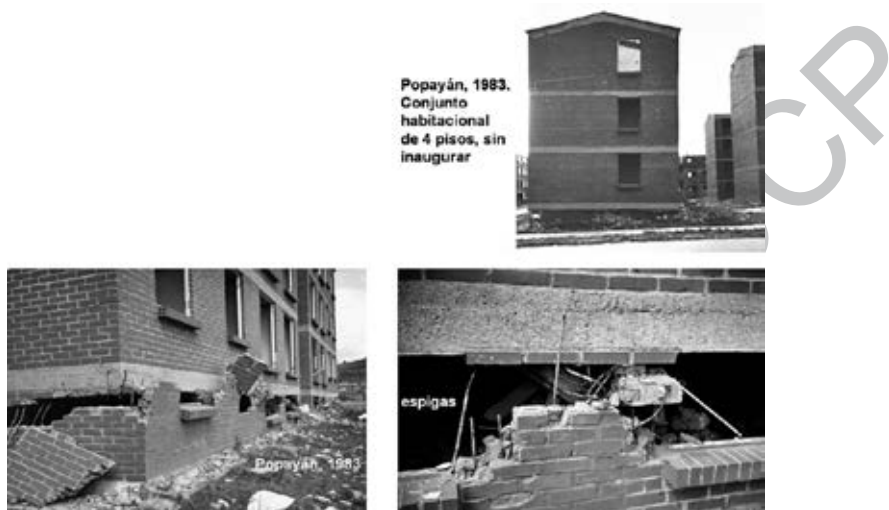
Fig. 5.17. Colapso de edificios de albañilería armada.
