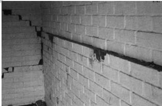
Fig. 7.3. Falla por deslizamiento.
