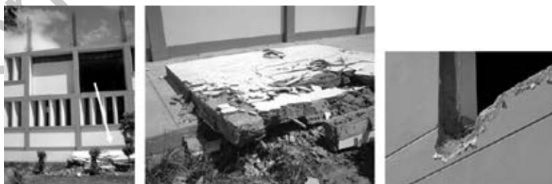
Fig. 7.68. Colapso de un tabique aislado con refuerzo vertical de la columneta anclado superficialmente en el recubrimiento de la viga de apoyo. Sismo de Pisco, 2007. Ver el proceso correcto de anclaje en la Fig. 5.38.
