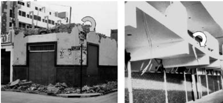
Fig. 7.89. Volcamiento de parapetos no arriostrados.
