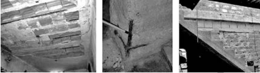
Fig. 4.49. Corrosión del refuerzo.
