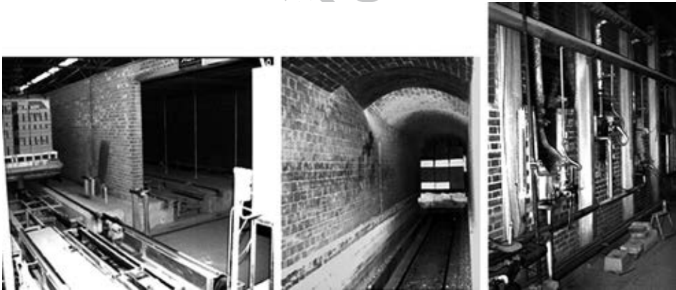
Fig. 2.17. Horno tipo túnel.
