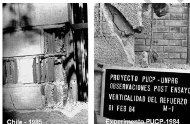
Fig. 5.21. Pandeo del refuerzo vertical.
