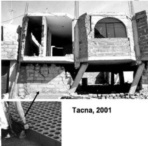
Fig. 5.37. Falla por compresión seguida de piso blando.
