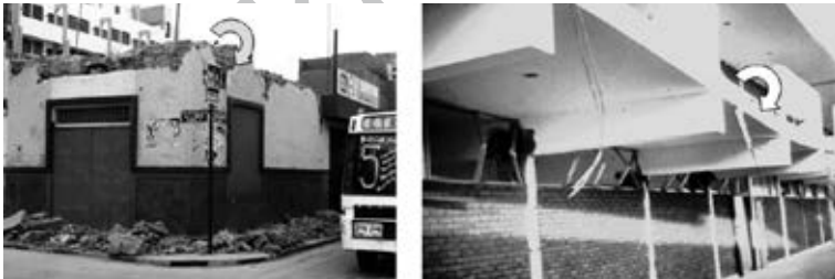
Fig. 5.41. Parapetos no arriostrados.
