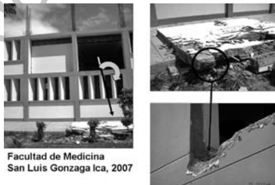
Fig. 5.39. Volcamiento de tabiques aislados, debido a que el refuerzo vertical de las columnas de arriostres anclaba sobre el recubrimiento de la viga de apoyo. Ver la solución 3 en la Fig. 5.38.
