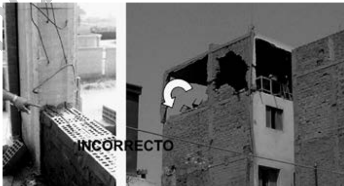
Fig. 1.27. Procedimiento constructivo incorrecto y consecuencia.
