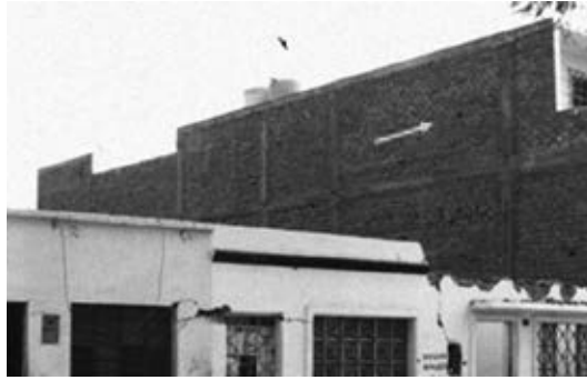
Fig. 7.23. Resistencia excesiva en la dirección longitudinal.
