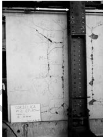
Fig. 4.93. Grietas verticales del empaste en el encuentro entre pilares.
