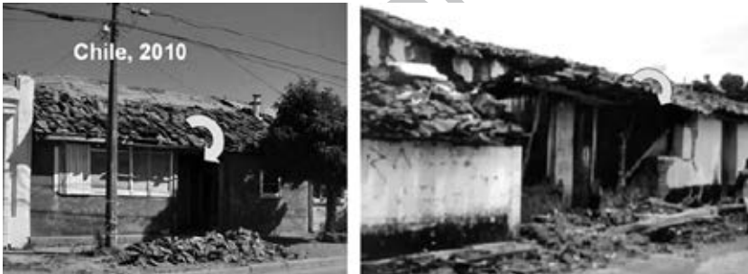
Fig. 8.10. Desprendimiento de las tejas artesanales.
