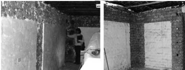
Fig. 8.43. Remoción de acabados en zonas a enmallar (izquierda) y perforaciones cada 0.5m (derecha), donde irán los conectores.
