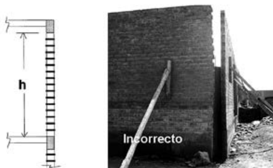
Fig. 6.26. Altura libre (izquierda) y desplomo en muro esbelto (izquierda).
