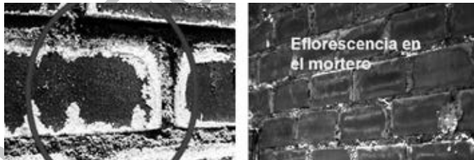
Fig. 2.51. Eflorescencia en la unidad y en el mortero.
