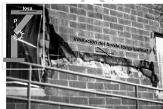
Fig. 7.5. Pérdida de la sección transversal.
