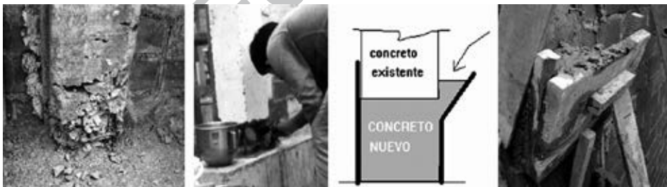
Fig. 4.45. Reparación de cangrejera.
