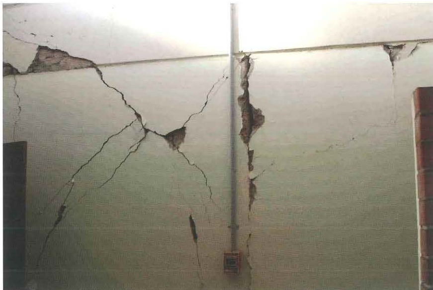
Figura 1. Grieta vertical y diagonal en tabiquería.
