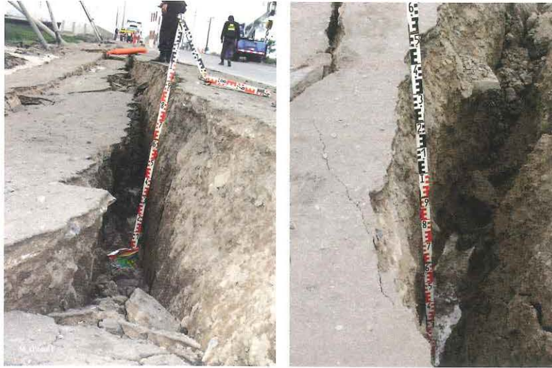
Figura 10.- Av. Defensores del Morro (Chorrillos, Lima). - Vistas de las grietas causadas por el desplazamiento lateral por licuación, las que presentaron profundidades variables entre 0.65 y 1.36 m (a) Sentido Noroeste Sureste. (b) Sentido Sureste Noroeste.
