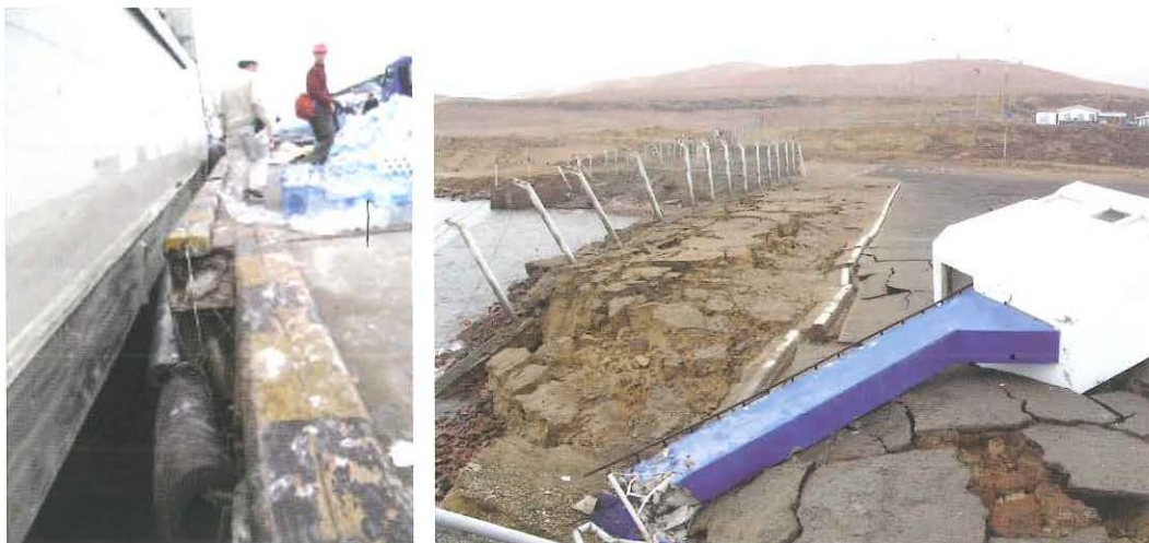
Figura 32.- Terminal Marítimo General San Martín.- (a) Desplazamiento lateral permanente de 0.50 m en las juntas del muelle. (b) Grietas en relleno y colapso de la torre de vigilancia.
