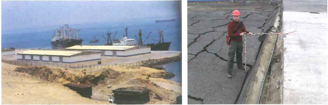
Figura 30.- Terminal Marítimo General San Martín.- (a) Suelo ganado al mar. (b) Distorsión vertical de 1.20 m entre embarcadero y el pavimento construido sobre relleno artificial.
