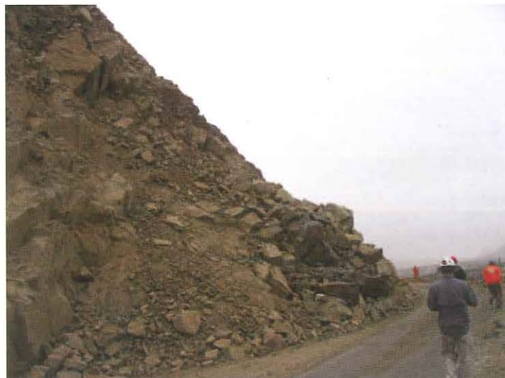
Figura 38.- Fallas de estabilidad de taludes.- Deslizamiento de rocas en la Vía Los Libertadores.
