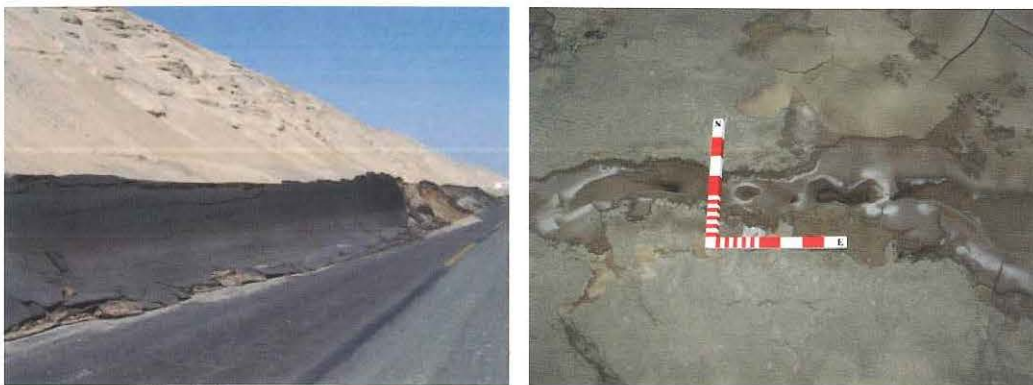
Figura 18.- Talud en Jahuay.- (a) Daños en la berma y el pavimento de la calzada norte de la carretera Panamericana. (b) Entre el talud y la berma de la carretera se encontró una eyección de arena limosa y limo.
