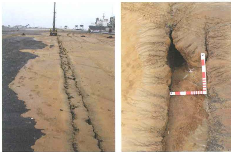
Figura 31.- Terminal Marítimo General San Martín.- Eyección de arena limosa en las juntas del pavimento asfáltico del terminal
