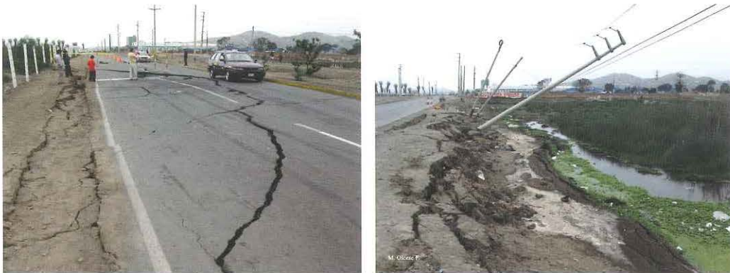
Figura 8.- Av. Defensores del Morro (Chorrillos, Lima).- Vistas de la licuación con desplazamiento lateral (0.30 m en ambos lados) (a) Sentido Noroeste Sureste. (b) Sentido Sureste Noroeste.
