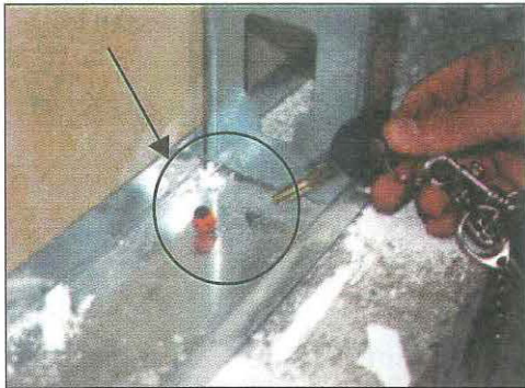
Foto 7. Falla del perno por cizalla.
