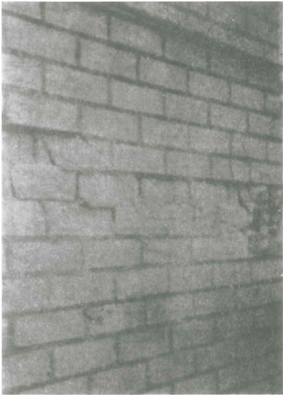
10.7. Falla en compresión de la albañilería en el muro mostrado en la figura 10.6
