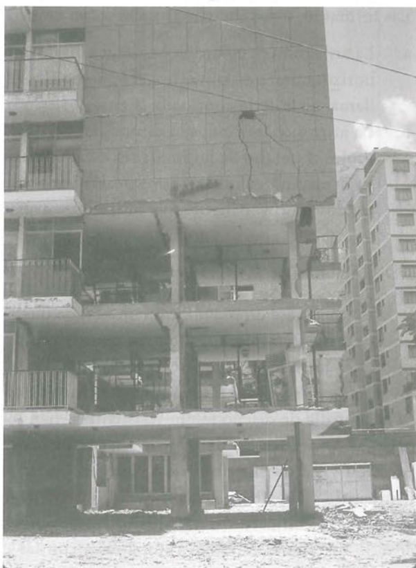
1.10. Caracas, Venezuela (1967). Se han volcado los muros de cierre de albañilería como consecuencia de la acción sísmica.
