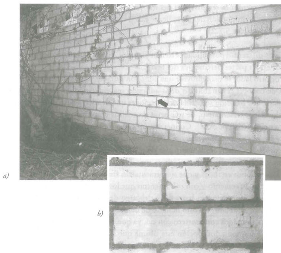
5.4. a) Ubicación del agrietamiento en la interfase mortero-unidad de arriba, en la rotura de un muro. b) Detalle de la separación.
