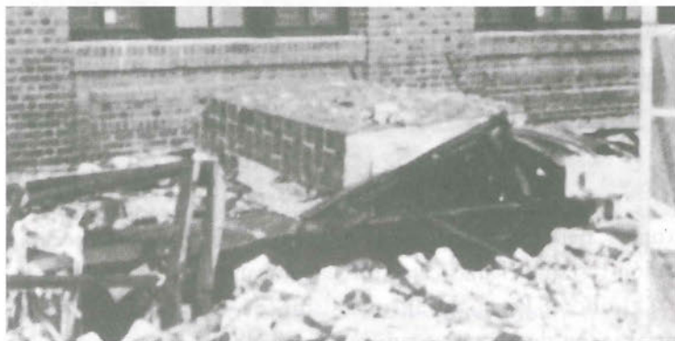
11.2. San Francisco, California (Estados Unidos). Efecto del sismo de Loma Prieta, 17 de octubre de 1989. M_s = 7,1 . a) esquema. b) Colapso del muro del último piso por volteo.
