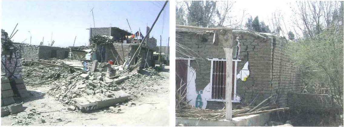
Fig. 12.- Casas vecinas de adobe en Pachacutec con fuertes daños en muros sin refuerzos.
