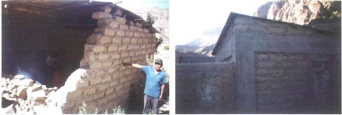
Fig. 7.- Efectos del terremoto del 2001. Arriba: Casa reforzada en Yacango, Moquegua y casas vecinas con muros dañados; Abajo: Casa reforzada en Caplina, Tacna y casas vecinas con muros dañados.
