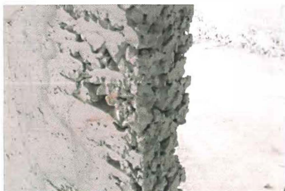
Foto 23. Segregación de Agregado
