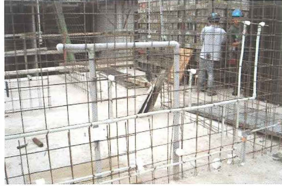
Foto 10. Tuberías de Agua Fría y Caliente dentro de los MDL
