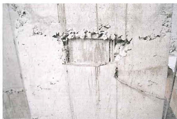
Foto 22. Cangrejeras en zonas de concentración de tuberías
