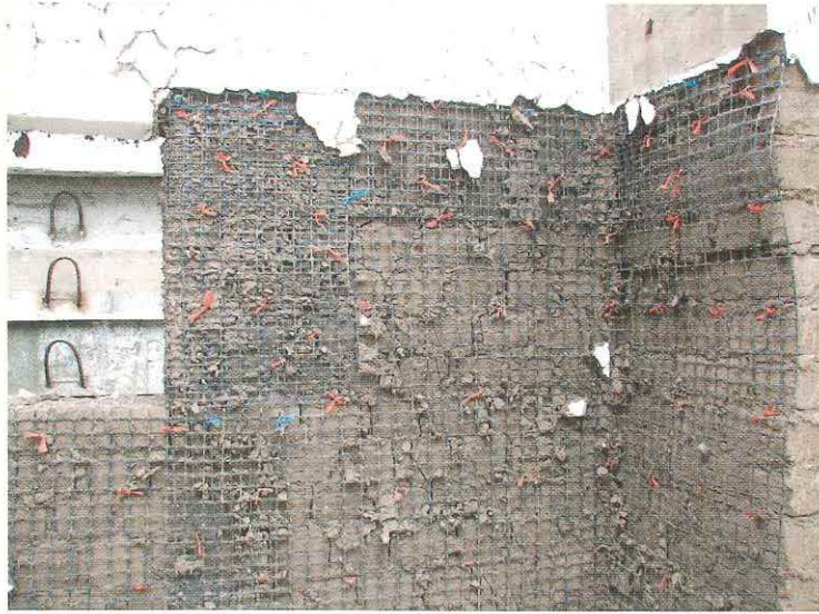
Figura 11. Deterioro interno del muro después de haber perdido el tarrajeo.
