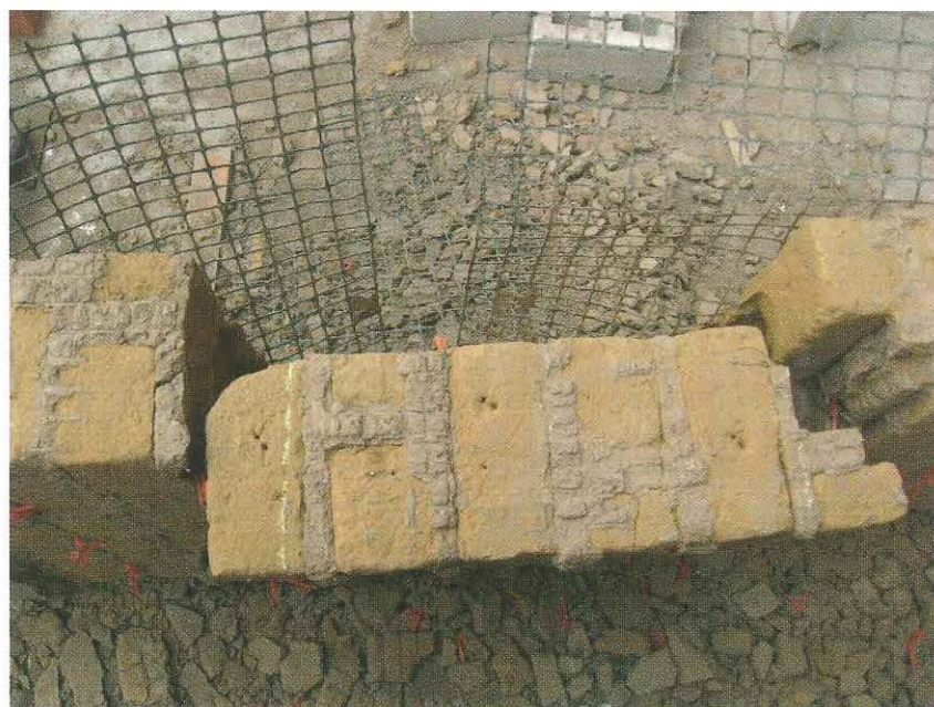
Figura 19. Estudio pos ensayo del muro. Se aprecian las grietas por las juntas en la zona central por flexión y en la lateral por corte.
