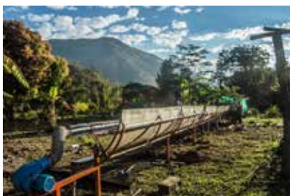
Fig. 2: Instalación de Concentradores Lineales
