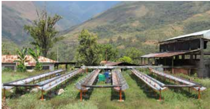
Fig. 1: Foto panorámica de sistema instalado en la empresa AGROINKA de Cusco
