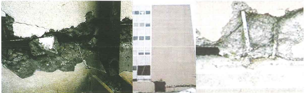
Foto 1. Falla por deslizamiento.
