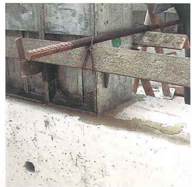
Filtración de lechada
