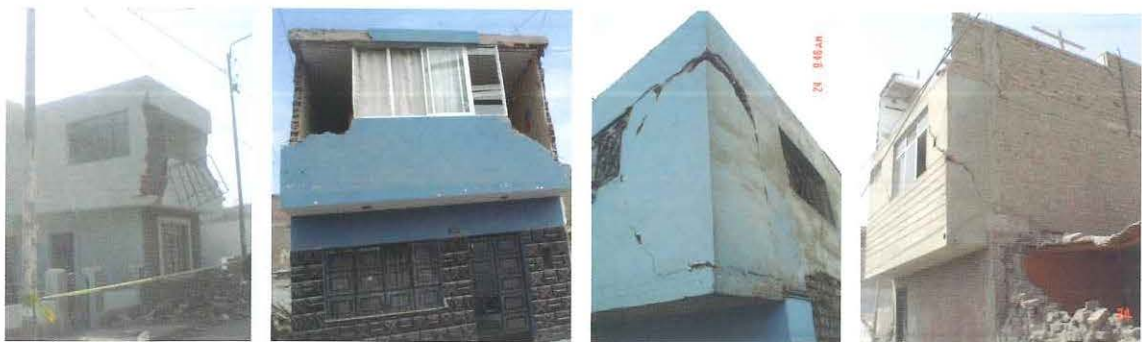
Fig. 12. Tabiques sobre voladizos en Pisco y Chincha.
