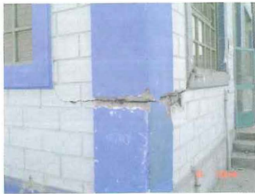
Fig.19. Columna de concreto sin refuerzo.
