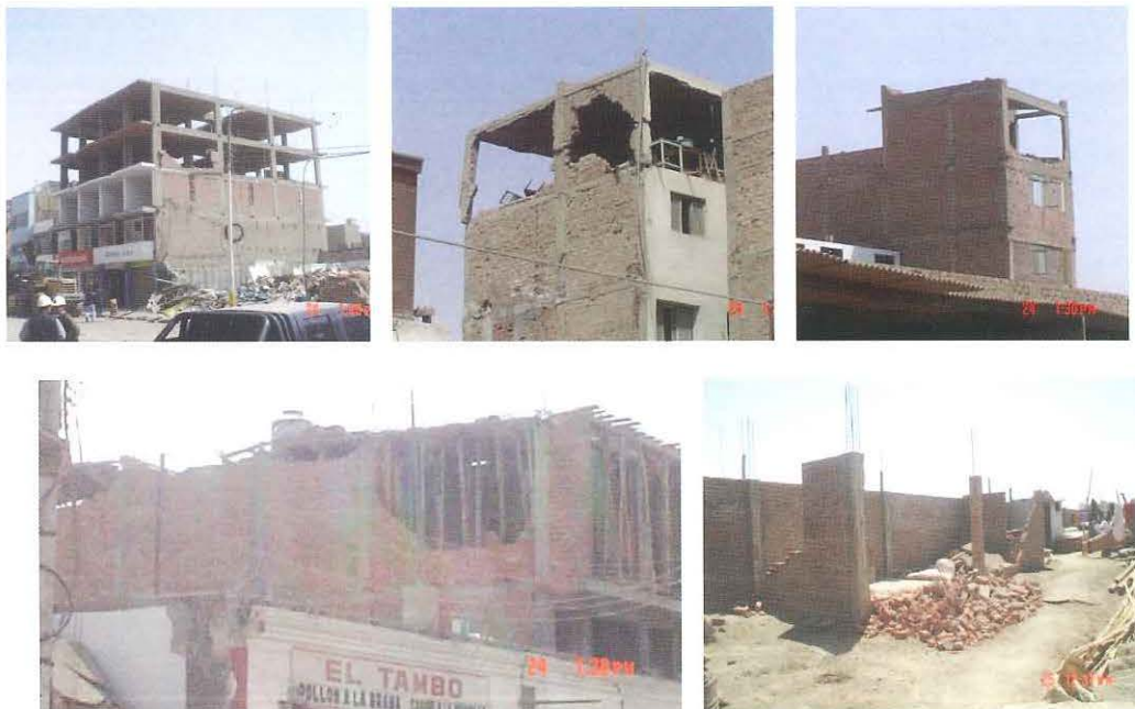
Fig.9. Volcamiento de muros con junta a ras con las columnas. Inadecuadamente las columnas fueron construidas primero y después se levantó la albañilería. Pisco.
