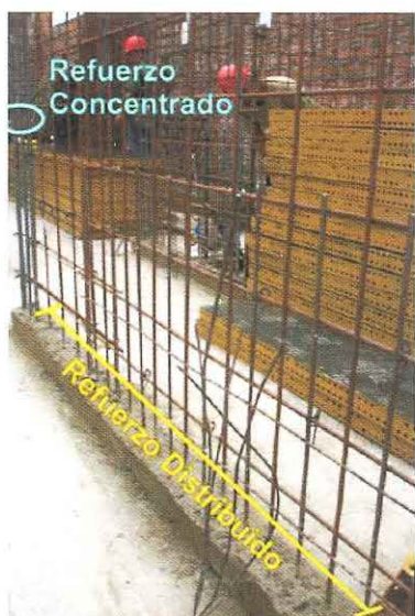
Foto 3. Refuerzo Distribuido y concentración en los muros
