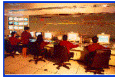
Sistema Integrado de Control de Autopistas
