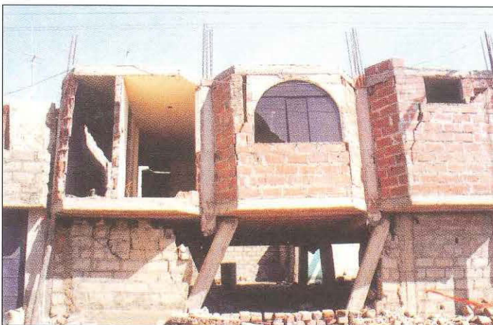
Foto 28. Falla por mecanismo de piso blando en una vivienda en Tacna.
