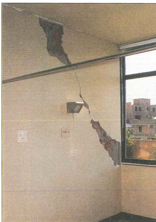
Foto 17. Daños en la tabiquería del Hospital Carlos Arlberto Seguí, Arequipa.
