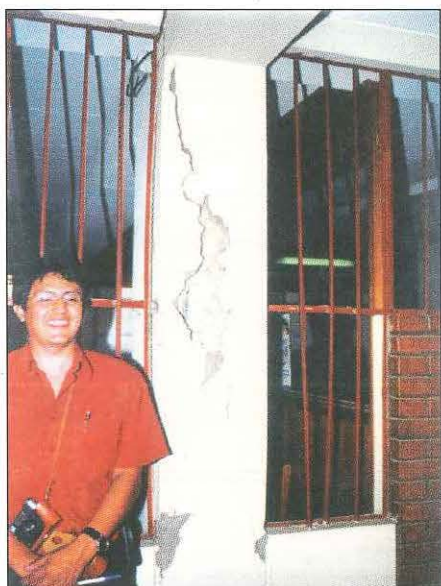
Foto 12. Daño típico de columna corta en edificios de la Universidad Nacional San Agustín de Arequipa.
