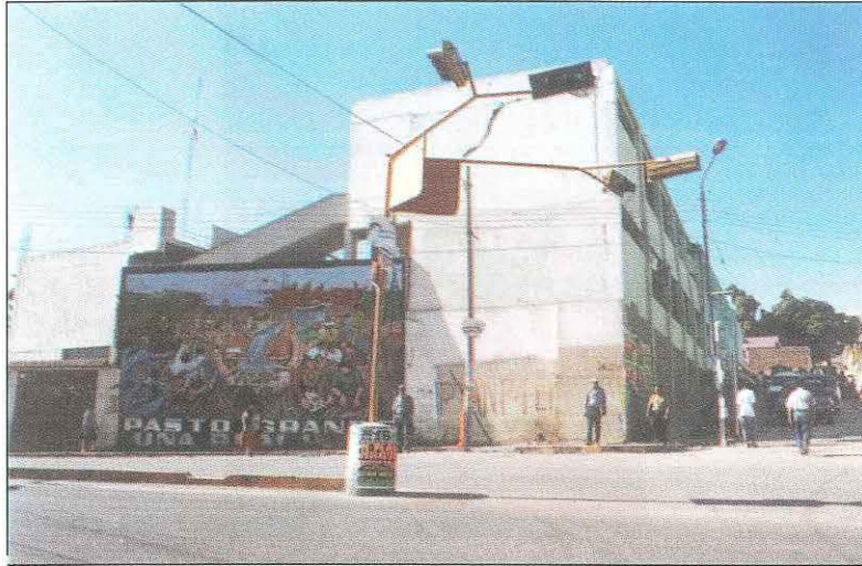
Foto 4. Daño irreparable en el Centro Educativo Angela Barrios de Moquegua.
