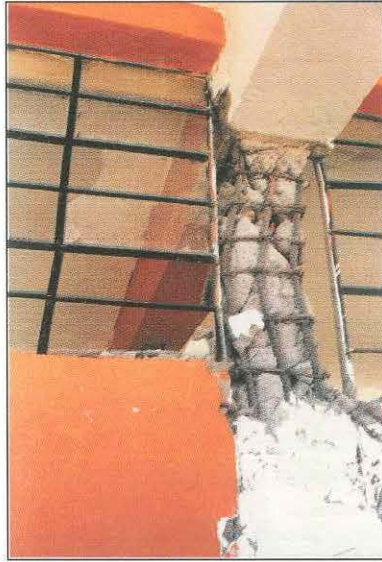
Foto 2. Falla de columna corta en un pabellón del Centro Educativo Casimiro Cuadros, Arequipa.
