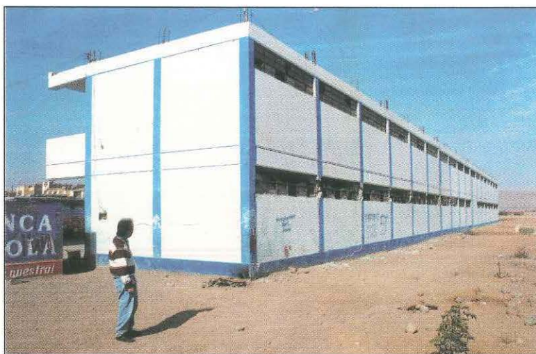
Foto 3. Falla en todas las columnas del primer piso por el problema de columna-corta, Centro Educativo Mariscal Cáceres, Tacna.
