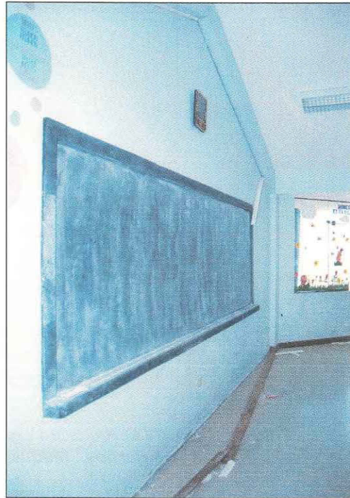
Foto 9. Los tabiques aislados y mal arriostrados quedaron inestables, Colegio Santa Fortunata en El Cerrillo, Moquegua.
