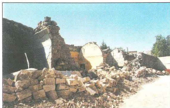
Foto 23. Vivienda de sillar colapsada en Arequipa.
