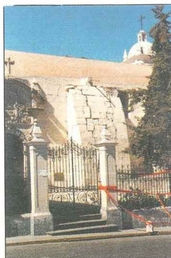
Foto 33. Grietas en los contrafuertes en la Iglesia Santa Marta de Arequipa, al controlar el movimiento del cuerpo central.
