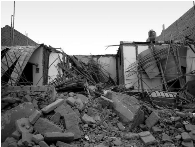
Figura 1. Construcciones de adobe destruidas por el terremoto de Pisco
