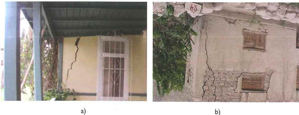
Foto 6. Grieta en esquinas mayores a 2cm, con separación de muros y ligero desplome: a) Chíncha 2007, foto D.Torrealva y b) Arequipa 2001, foto D. Quiun.
