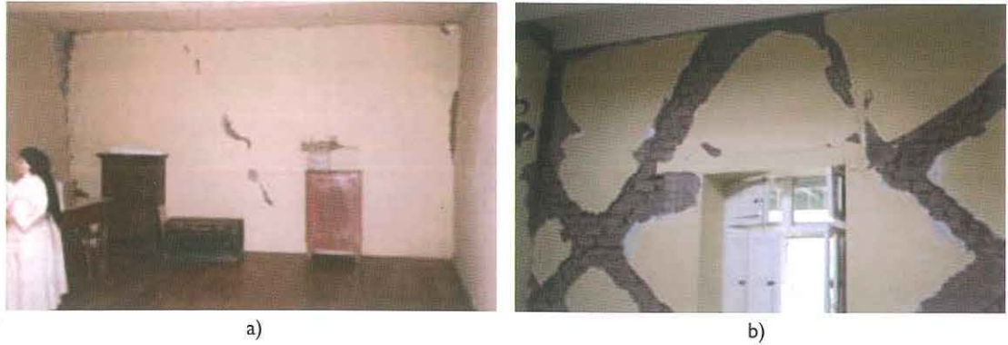
Foto 4. Grieta inclinada por fuerza en el plano: a) En muro interior, Cuzco 1985, foto D.Torrealva, b) En muro interior, Ica 2007, foto D.Torrealva.
