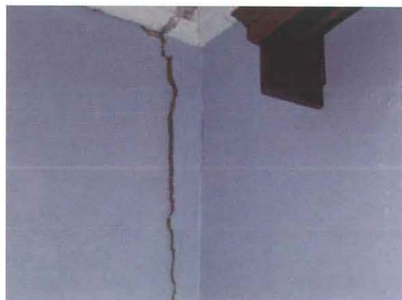
Foto 1. Grietas verticales en muros interiores Ica 2007, foto D. Torrealva
