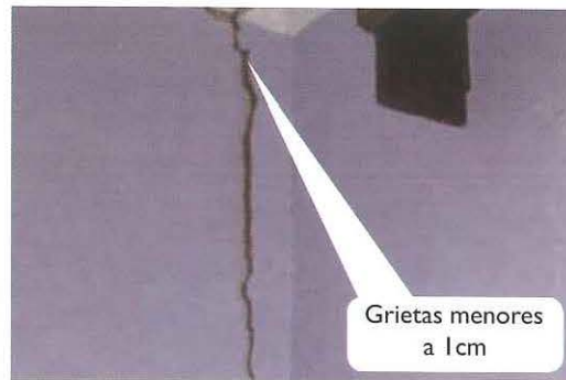
Foto 5. Grieta vertical menor a 1cm, sin desplome visible. Chíncha 2007, foto D.Torrealva.
